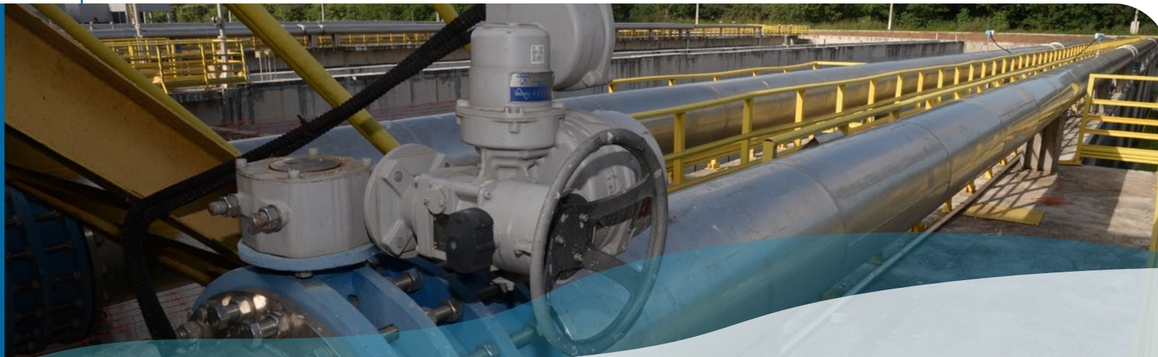
Visita técnica a ETE Dr. Hélio Seixo de Britto e ETE Parque Atheneu, ambas localizadas no município de Goiânia
