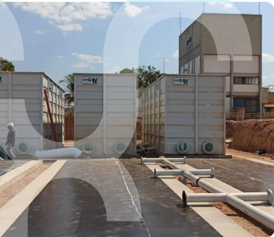
ETA Compacta de Uruaçu
