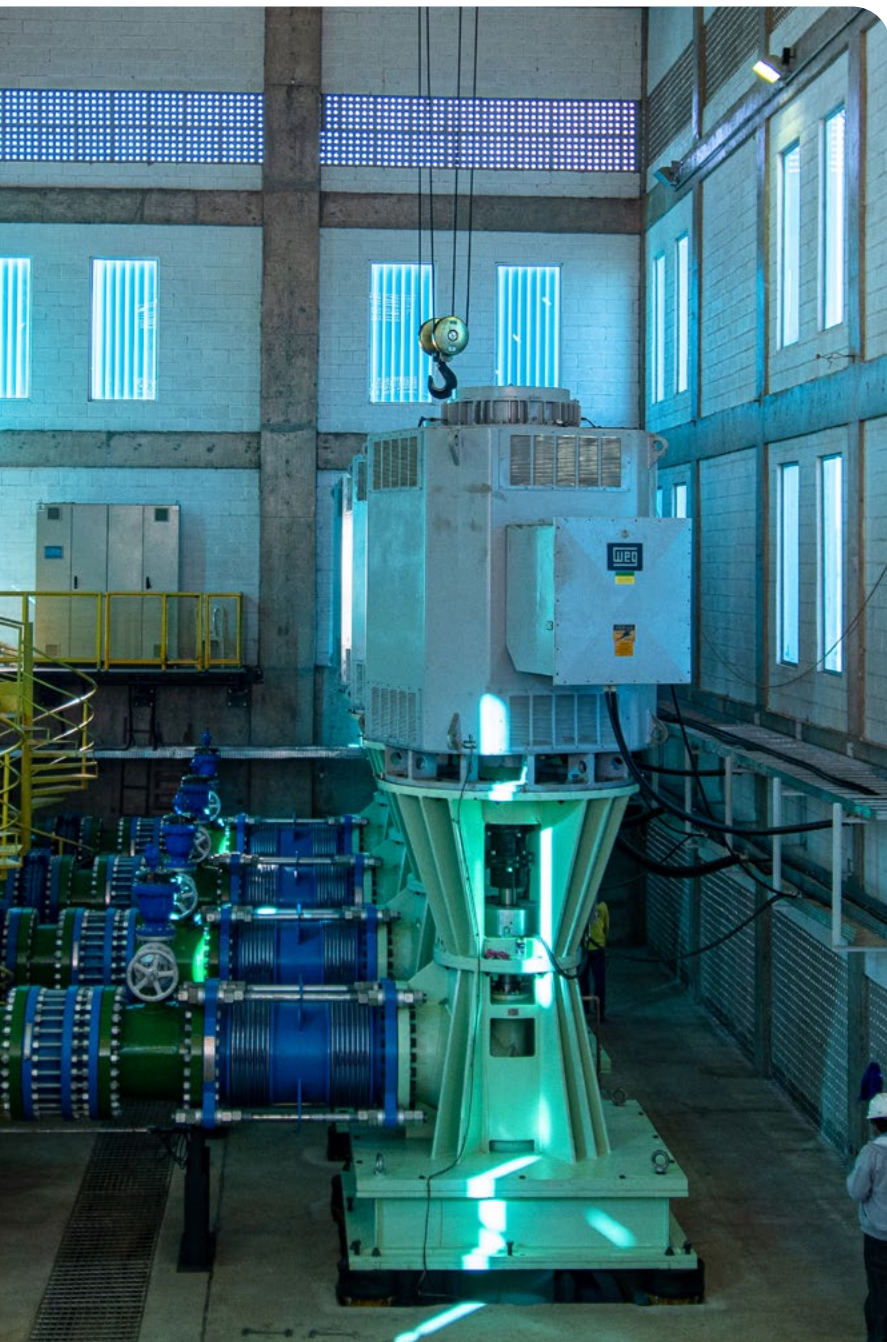
Elevatória Sistema Corumbá
